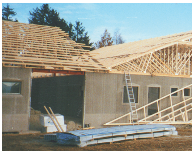
Figur 2.11.1 Landbruksbygg. Leverandør: Bredesen Opseth AS.
