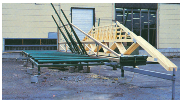
Figur 9.15 Automatisk stabler for takstoler (kilde: Ring-Ålm AS).
